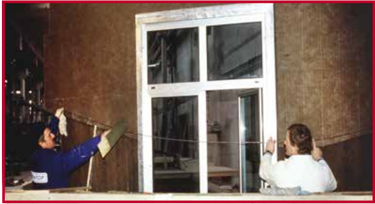
Zur Nacharbeitung der Wellenkanten musste deren Verlauf auf eine zweite Schicht HECK MW-Dämmplatten 040 übertragen werden.
