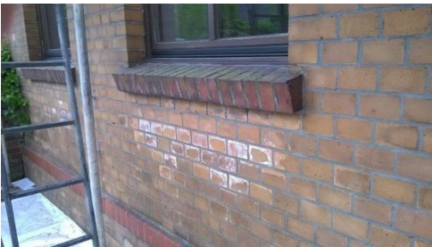
Auf der Backsteinoberfläche kam es zu Salzausblühungen.
