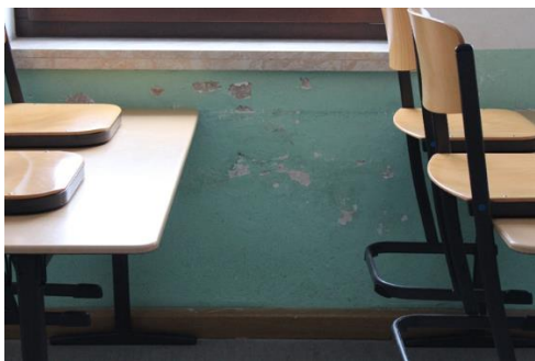
Gravierende Feuchteschäden in den Innenräumen der J.W. Goethe Grundschule in Eisenhüttenstadt.
