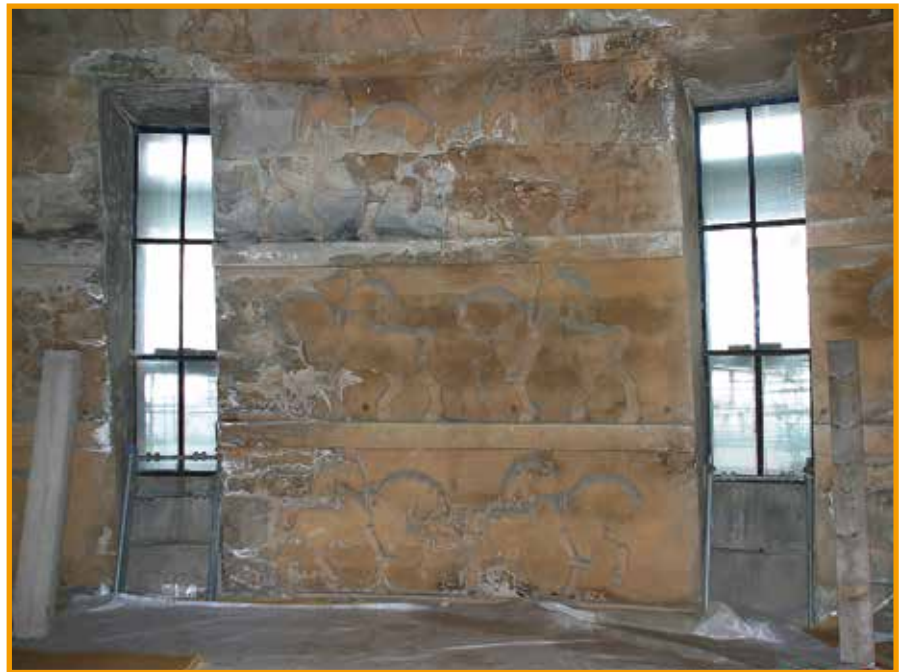
Durch jahrzehntelangen Feuchteintrag gezeichnet: Ein Ausschnitt des Reiterreliefs vor der Sanierung
