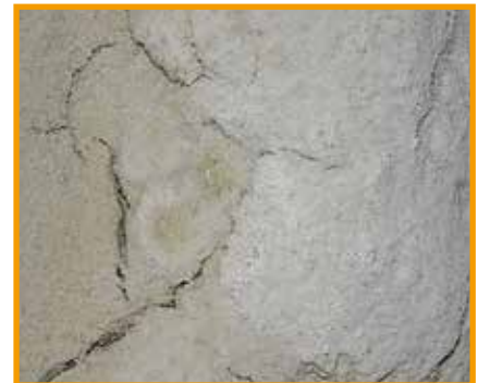
Reiterrelief mit Salzkompressen und Salzausblühungen
