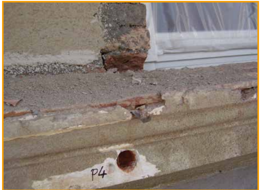
Probeentnahmestelle am Gurtgesims: Ausbessern oder erneuern?
