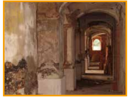
Massive Schäden auch im Innenbereich des ehemaligen Hotelgebäudes.
