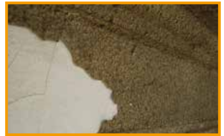
Typisches Schadensbild am Gurtgesims: Putzabplatzungen.
