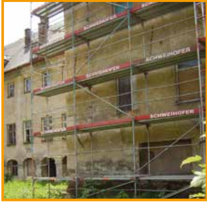
Blick auf die Nordseite: Aufgrund sehr starker Feuchte- und Salzbelastung wurde diese Gebäudeseite komplett mit dem Rajasil Sanierputzsystem SP3 bzw. SP3 PLUS instand gesetzt.
