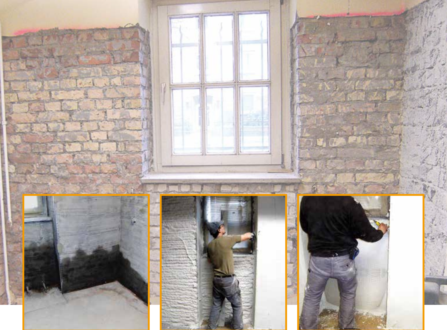
Hoch durchfeuchtetes Mauerwerk zeichnet sich im Putz ab.
