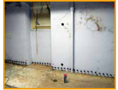
Aufsteigende Feuchtigkeit sorgte für raumhohe Salzausblühungen und Abplatzungen an den Keller- außenwänden der Staatlichen Gewerbeschule.
