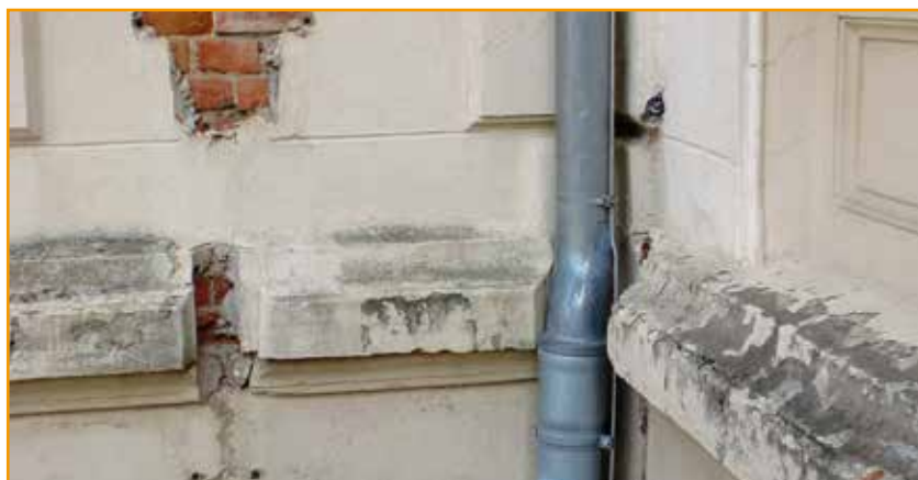
Aufsteigende und eindringende Feuchtigkeit haben die Fassade der Grundschule Annaburg massiv geschädigt. Die Fallrohre wurden bereits erneuert.
