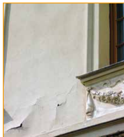
Großflächige Putzabplatzungen insbesondere zwischen den Fenstern. Zu erkennen sind aber auch die gut erhaltenen Zierelemente unter den Fenstern.
