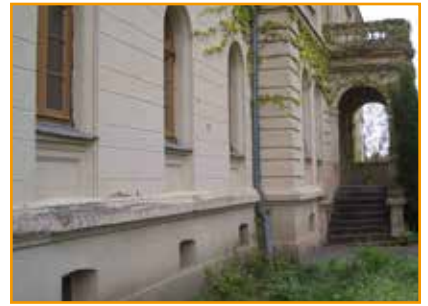
Das Sockelgesims weist erhebliche Schäden auf.
