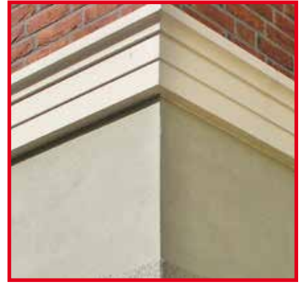
Stilecht: An den Ladenlokalen und im Innenhof wurden Putzflächen als Bossen nachgebildet
