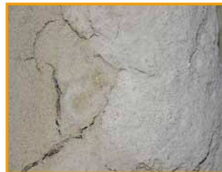
Reiterrelief mit Salzkompressen und Salzausblühungen
