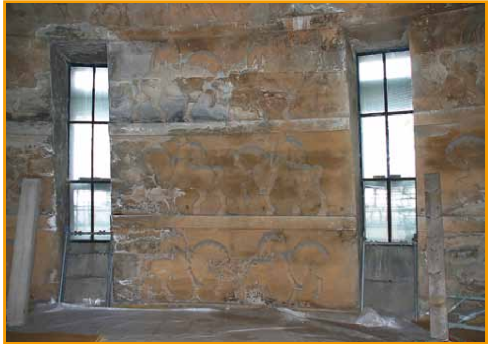
Durch jahrzehntelangen Feuchteintrag gezeichnet: Ein Ausschnitt des Reiterreliefs vor der Sanierung
