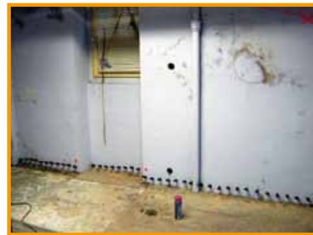
Aufsteigende Feuchtigkeit sorgte für raumhohe Salzausblühungen und Abplatzungen an den Keller Außenwänden der Staatlichen Gewerbeschule.
