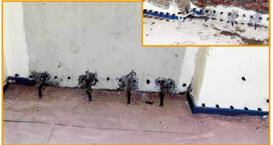
Die Vorbereitungen sind abgeschlossen und das mehrstufige Injektionsverfahren hat begonnen. Bild rechts oben: Erst nach dem Injektionsverfahren wurde der Altputz entfernt.
