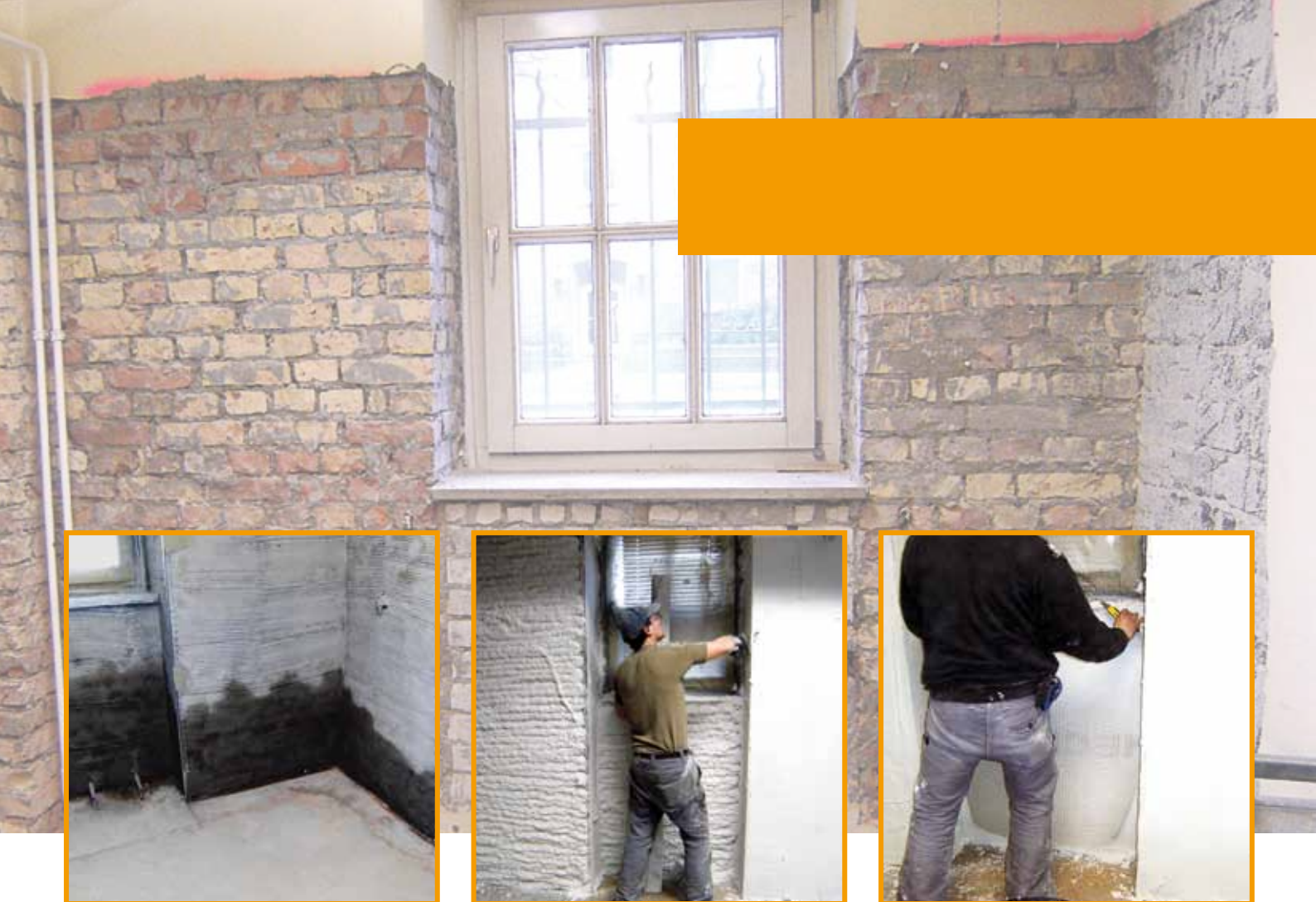
Hoch durchfeuchtetes Mauerwerk zeichnet sich im Putz ab.
