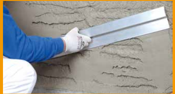
Sperrputz: Der Sperrputz Rajasil SPP schafft einen geeigneten Untergrund und egalisiert die Wandoberfläche.
