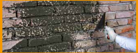
Haftbrücke: Vorbereitung des Untergrunds und Anbringen des Spritzbewurfs Rajasil SPB als Haftbrücke.
